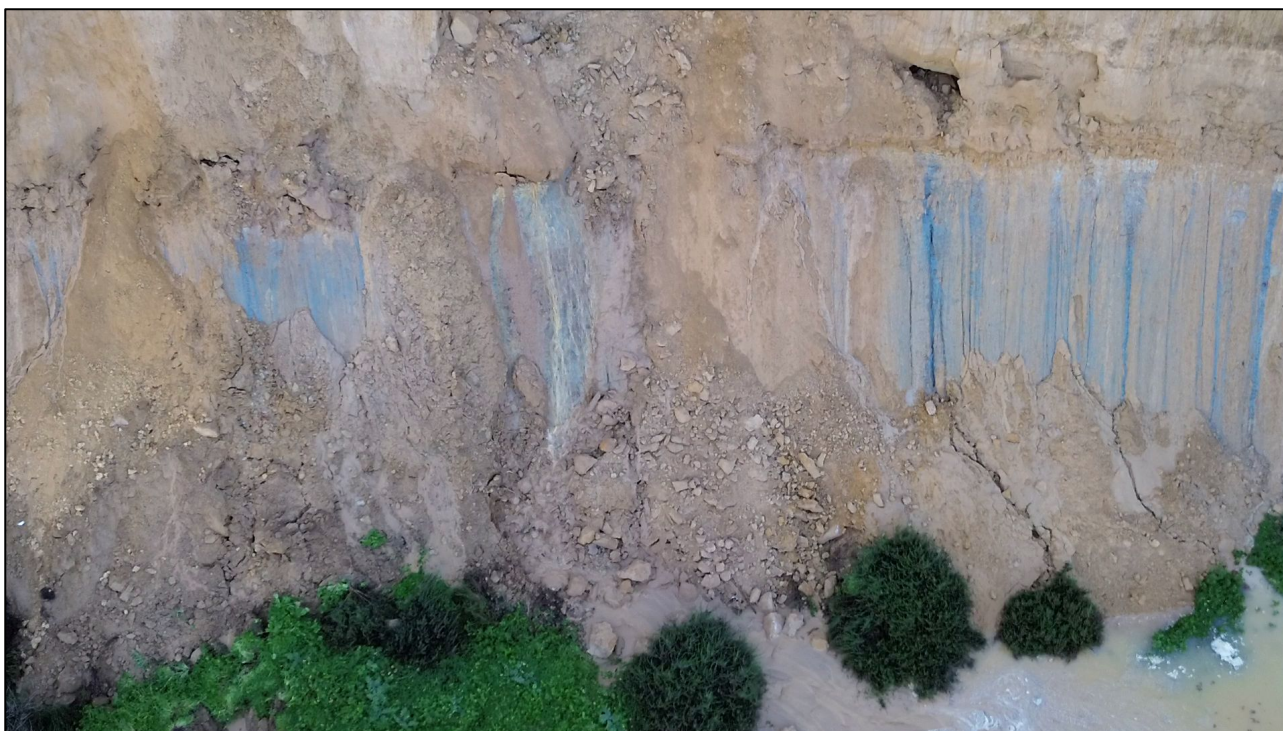
Figura 17 - Venute d'acqua lungo la scarpata della frana del 25-26 gennaio, al contatto fra le sabbie e le argille.
