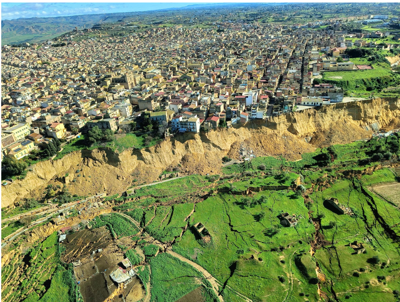
Figura 158 - Particolare della scarpata principale della frana di Niscemi nella zona del quartiere Sante Croci. Immagine acquisita durante il sopralluogo da elicottero del 27 gennaio 2026 che mostra l'evoluzione in atto della scarpata con formazione di coni detritici.
